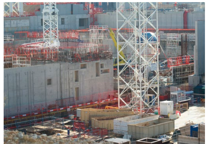
Un aperçu du chantier dans la fosse ; on y aperçoit la zone circulaire où reposera le réacteur
